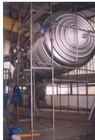
Abbildung 6. Vakuüm-Kristallisationsanlage während Installation
