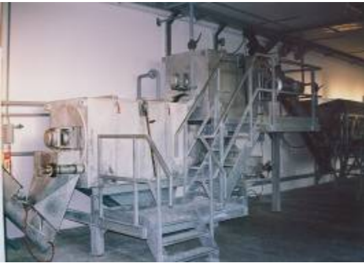
Abbildung 3. Waschwerk 1t/h kompl. unter Probetrieb
